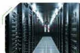
数据中心 Data center
